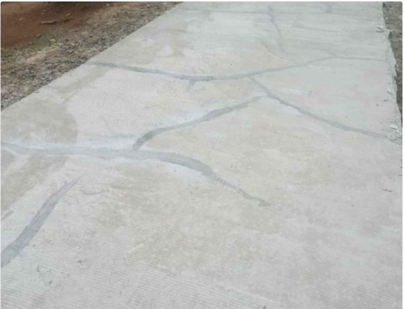
Pekerjaan beton yang belum lama dikerjakan nampak retak
